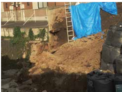
▲荒幡の柳瀬川護岸が崩れた場所
