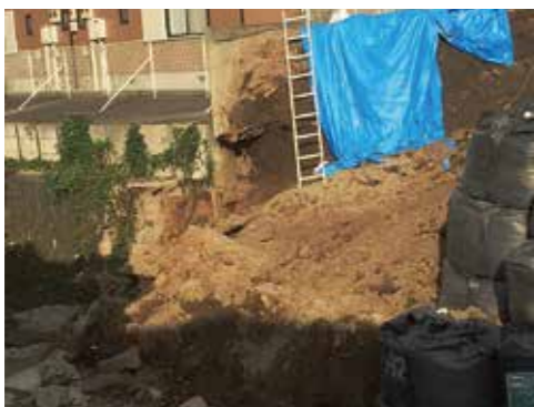
▲荒幡の柳瀬川護岸が崩れた場所
